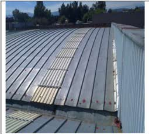
ANTES DE LA APLICACIÓN DE THERMOFORZZA
